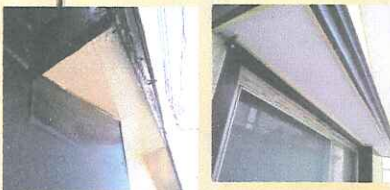
軒や戸袋はベニヤが劣化していました
