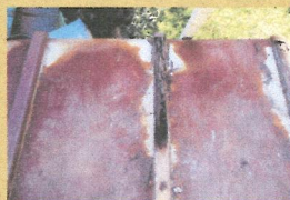
下屋根のトタンも錆が発生 していました。
