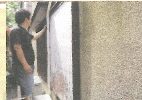
木製の戸袋は劣化。使っていないので撤去する事に。
