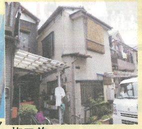
施工前...トタンのサビ・壁の塗膜の劣化が見られました。
