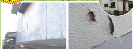
壁のひび割れ
